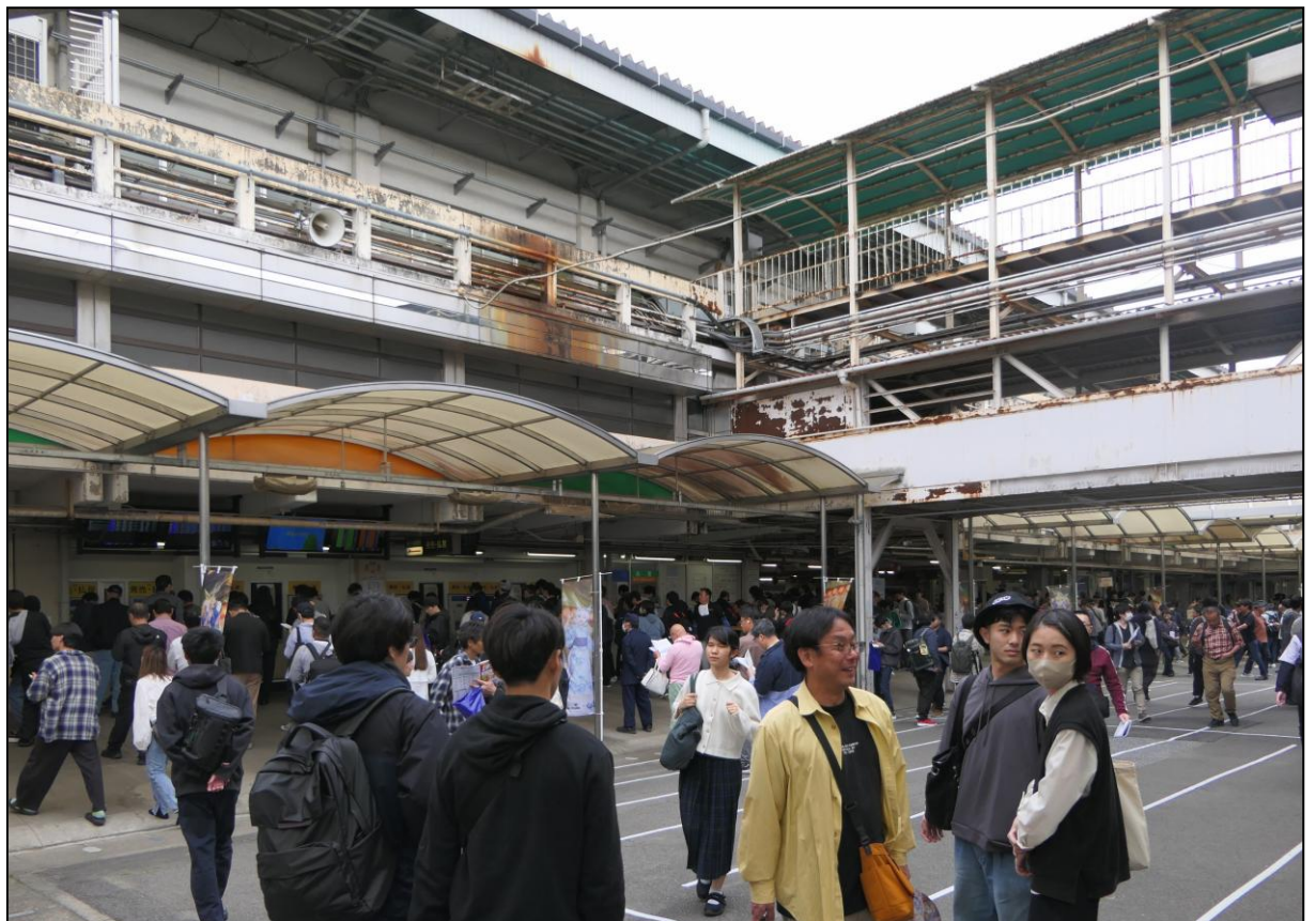
Überall Rost, blätternde Farbe, bröckelnder Putz.
